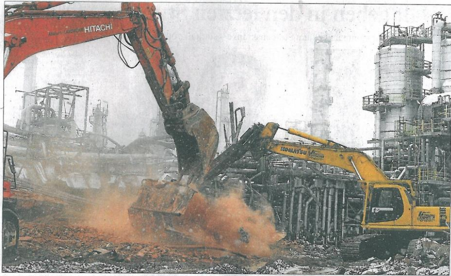
75-Hektar-Spielwiese: Die Bayernoil-Raffinerie wird dem Erdboden gleichgemacht – aber nicht ganz. Teile der Anlage sollen stehenbleiben und in die neue Bebauung integriert werden. So jedenfalls stellen es sich die Architekten vor, die sich am Gestaltungswettbewerb European 11 beteiligt haben. Insgesamt gab es 51 Vorschläge zur Nutzung des Areals. Foto: Strösch
